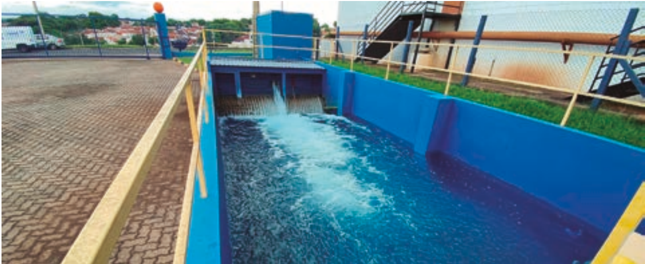
Sistema de captação de águas de chuvas da filial de Bauru (SP)
